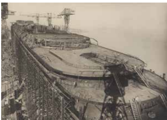
30. Anonyme, (Chantiers de Penhoët), Normandie en finition à Saint-Nazaire : ponts en terrasse de la poupe, 7 octobre 1932 Épreuve gélatino-argentique, 20 x 25 cm, Le Havre, French Lines & Compagnies, patrimoine maritime et portuaire © Collection French Lines & Compagnies
